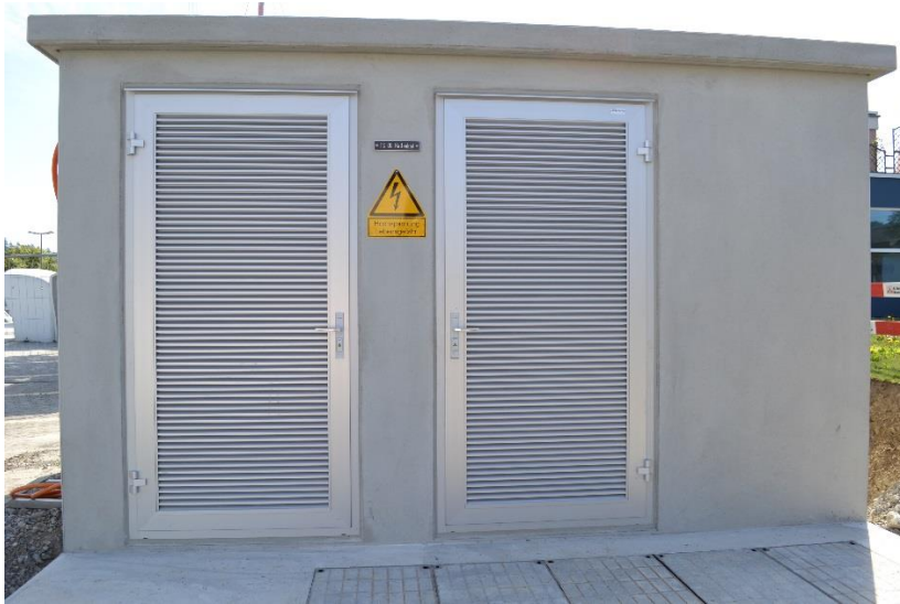
Neue Trafostation TS 06 Hallenbad
