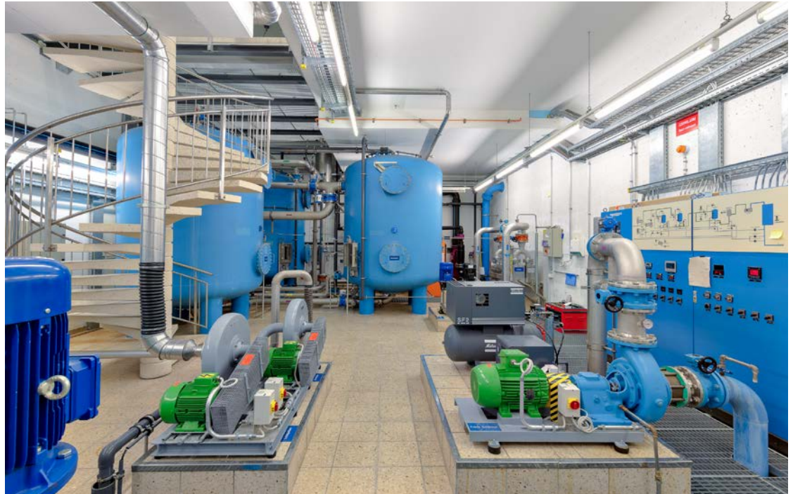
Tiefenpumpwerk «Hallenbad» «Geothermieranlage zur Wärmegewinnung aus dem Grundwasservorkommen»
