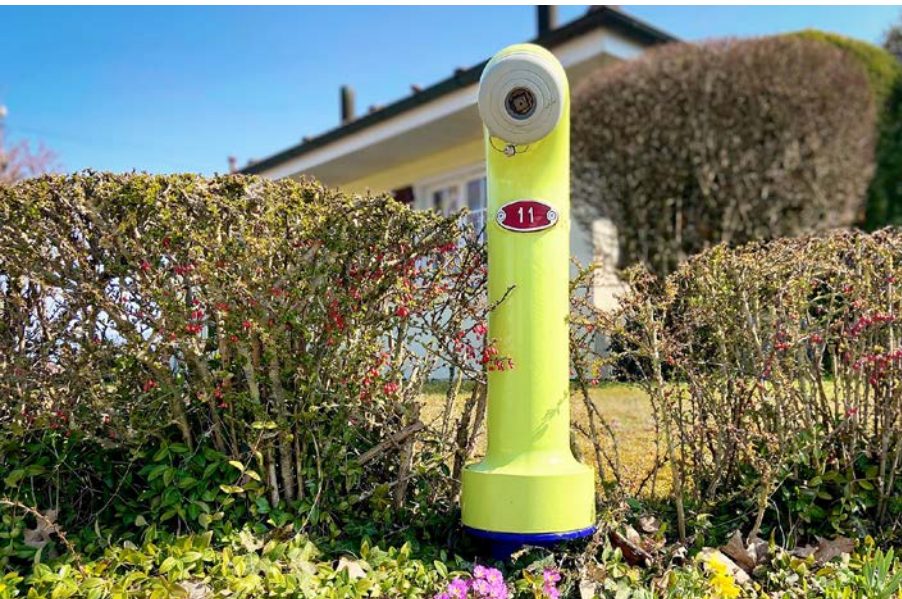
Einarmiger Überflurhydrant im Wassernetz der Gemeinde
