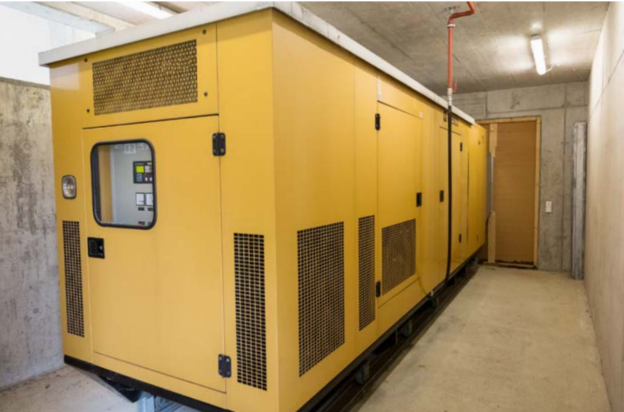
550kVA Notstromaggregat Tiefenpumpwerk «Hallenbad»
