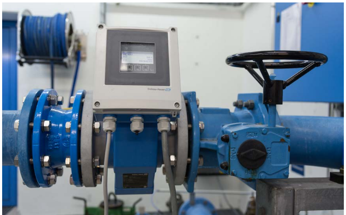
Tiefenpumpwerk «Hallenbad» «Schieberarmatur mit Durchflussmessung»
